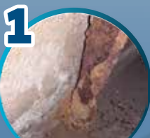
1 Antes Tanque dañado.
