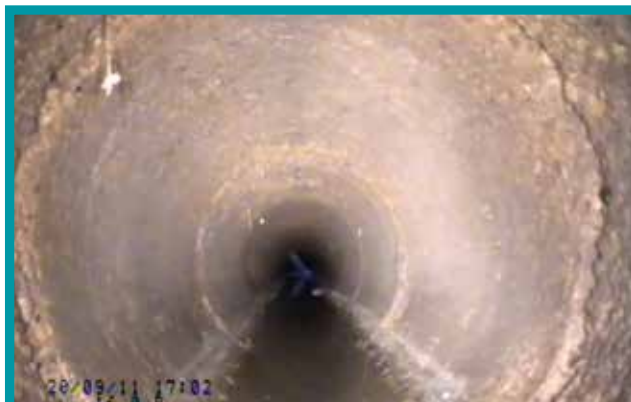
Tubería sin Rehabilitar
